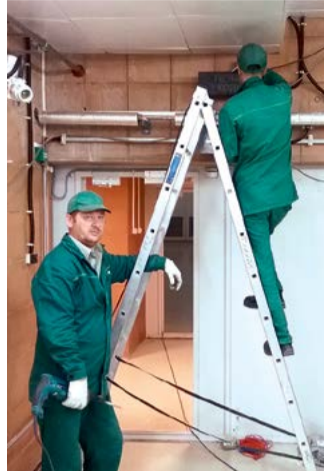
Качественный монтаж системы — залог ее долговечной работы. Работу производят монтажники С. В. Тетрадзе (слева) и А. Н. Никитин
