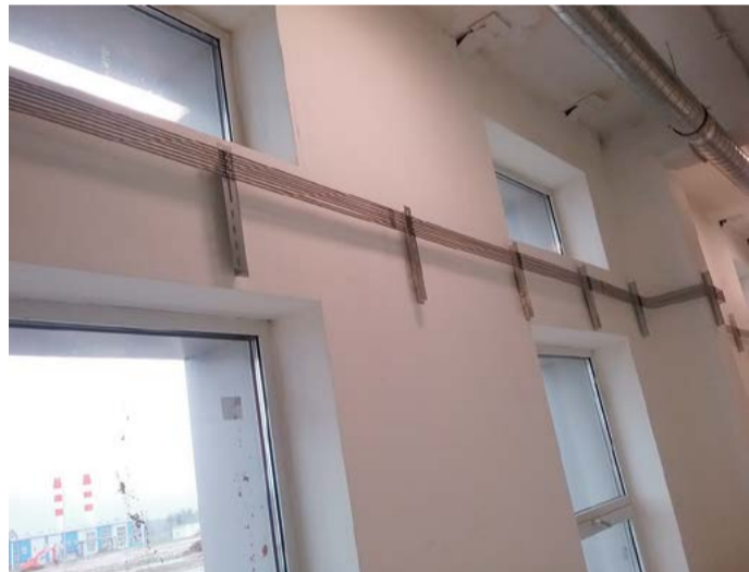
Красивый, качественный монтаж — фирменный стиль ПАО ЦНПО «КАСКАД»
