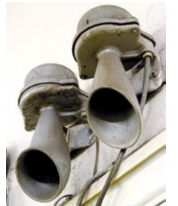
Классические системы оповещения, смонтированные в 30-е годы, еще можно встретить на станциях (эта на ст. «Смоленская»)
