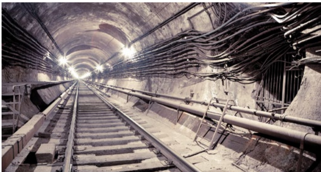
Метротоннель, современный вид. Кабели, проложенные вдоль стен, обслуживают не только сам метрополитен, но и многие городские службы
